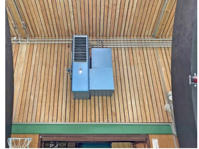
Bauzeitliches Lüftungsgerät. Auch die Temperierung der Halle erfolgt über die Lüftung.
