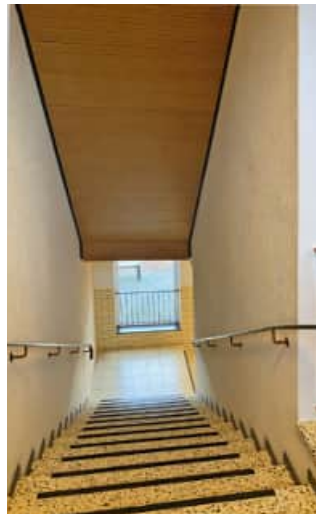
Die Treppenaufgänge zum Obergeschoss mit hölzernen Decken (Brandschutzproblematik)
