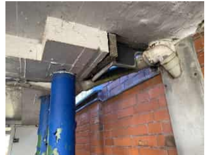
Die Dachentwässerung ist unvorteilhaft gelöst und weist deutliche Altersspuren auf.
