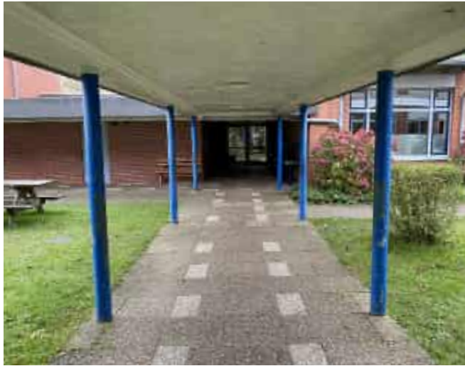
Die Farbeschichtung weisen altersgemäße Verwitterungsspuren auf.
