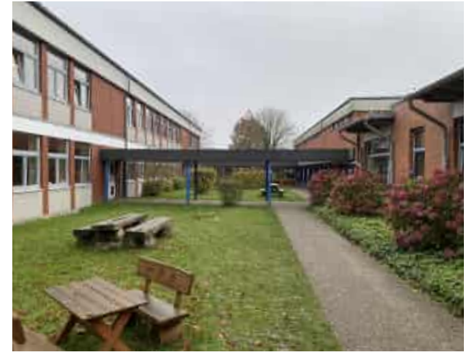
Die Dächer müssten teilweise saniert werden.
